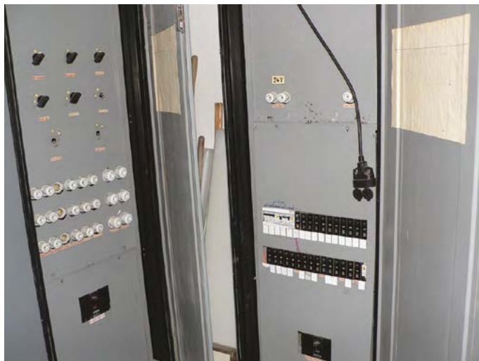
Nevyhovující elektrický rozvaděč.
