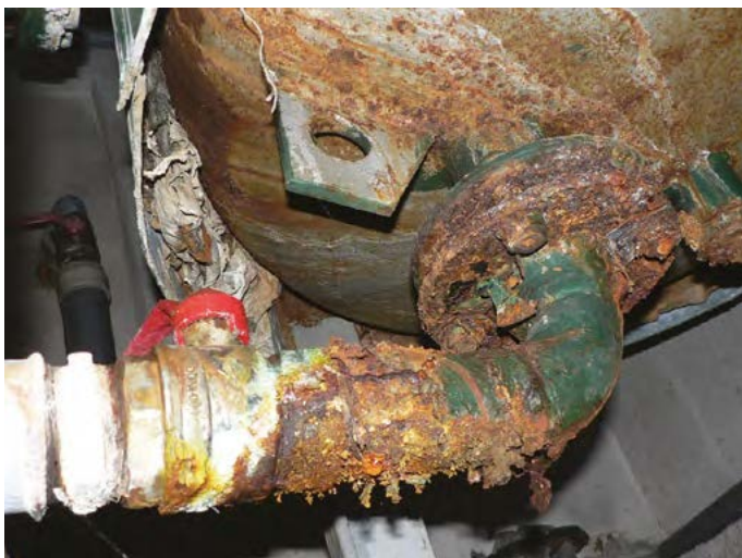
Staříčké bojler ve zdravotním středisku na Rohožníku jsou napadené korozí.
