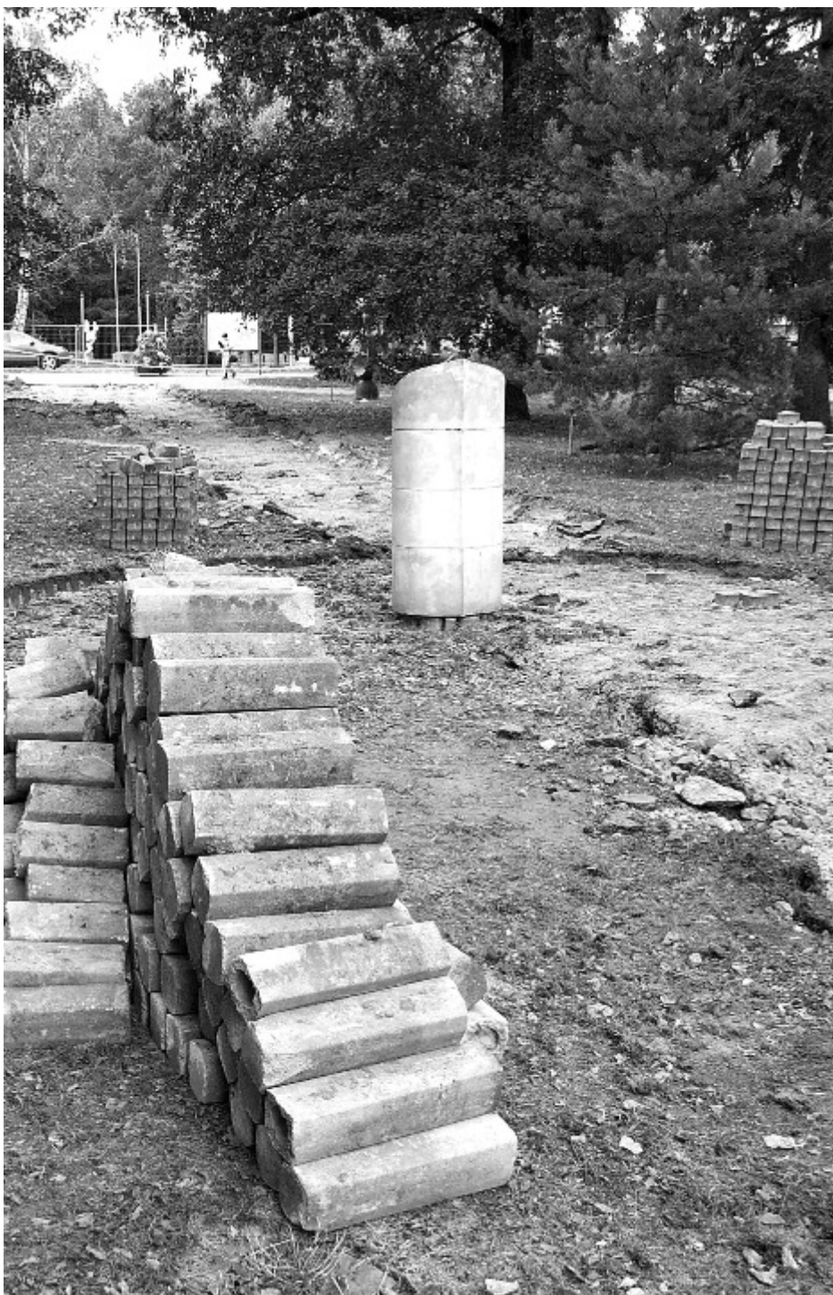
Práce na modernizaci aleje Hany Benešové běží naplno. FOTO KZ – Radomír Kůla
